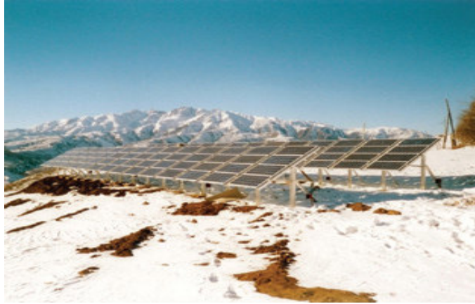
Figura 7.6. Sistem fotovoltaic off-grid pentru echipament de telecomunicații (sursa: http://www.yoursunyourenergy.com/es/electrificacion-de-zonas-rurales.htm# ).
