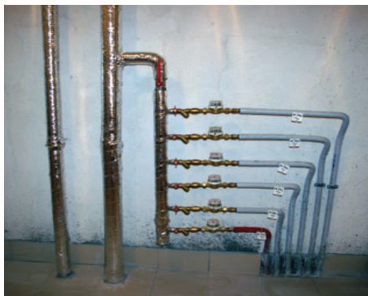
Figura 6.7. În interiorul unei încăperi tehnice de etaj, sunt prezentate coloanele magistrale de ACM și recirculare, contoarele individuale de ACM și distribuția ACM către apartamente (sursa: Fotografii Encon).
